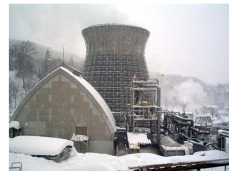
松川地熱発電所
